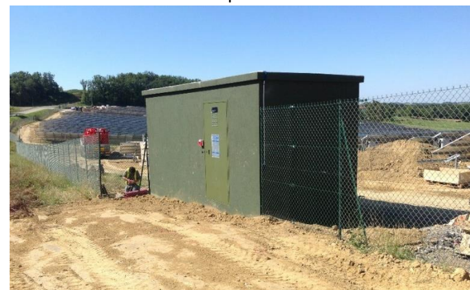
Exemple de poste de livraison sur un parc solaire
